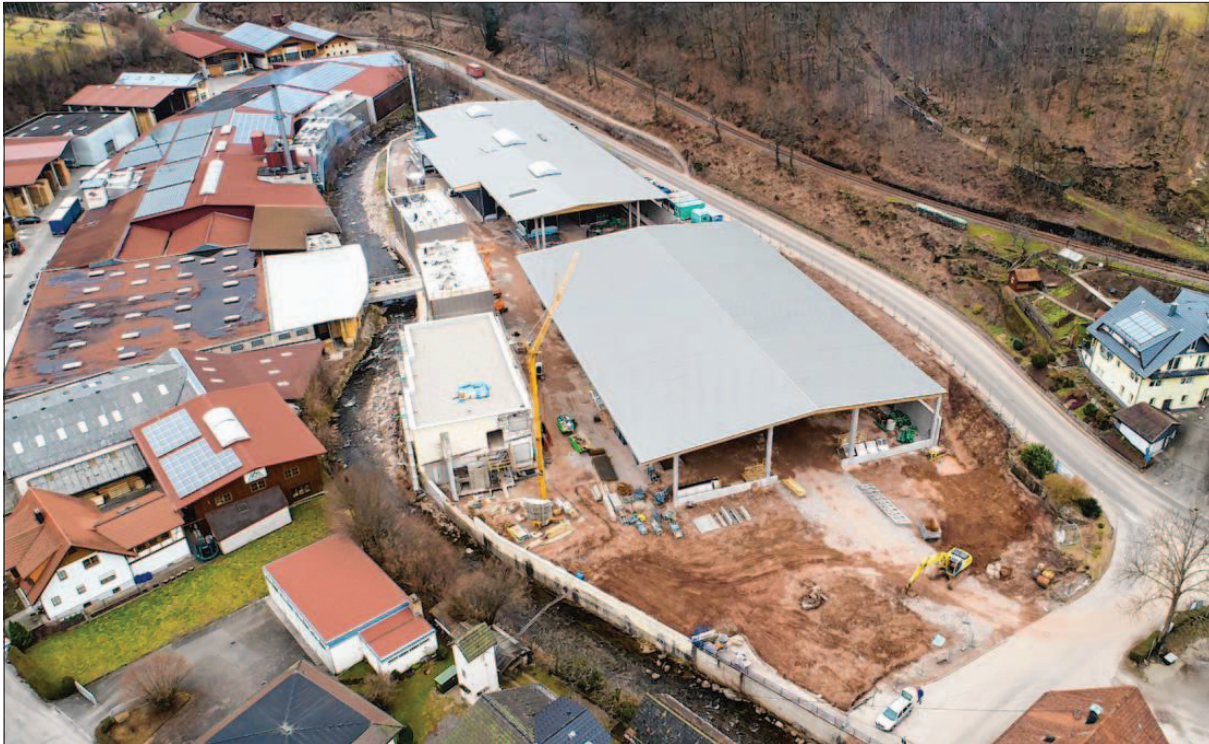
Großbaustelle am Ortseingang von Bad Peterstal: Die Firma Treyer Paletten erweitert ihre Produktion. Die Arbeiten sind bereits weit fortgeschritten und liegen im Plan. Mitte Juni soll die Produktion anlaufen.
