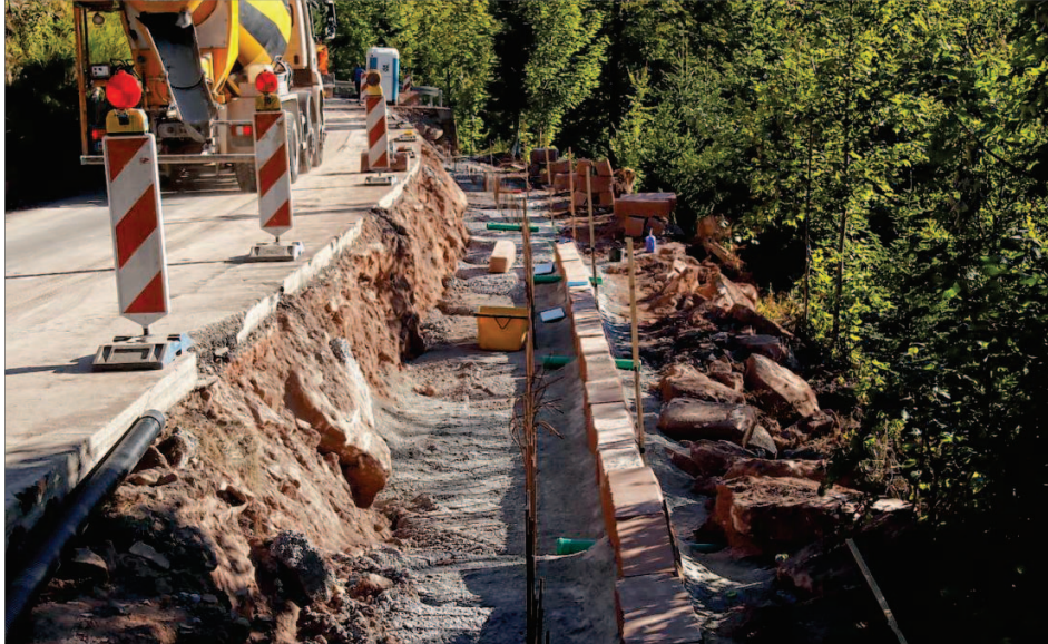
Der Aufbau der Stützwand: Auf der Talseite mehrere Lagen Sandsteine, alles hinterfüllt mit Beton.
